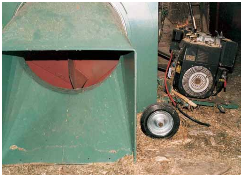
Fig. 3 - Soffianti per fieno non devono essere alimentati da motori a combustione (tubo di scarico rovente): produzione di scintille e pericolo di esplosione delle polveri
