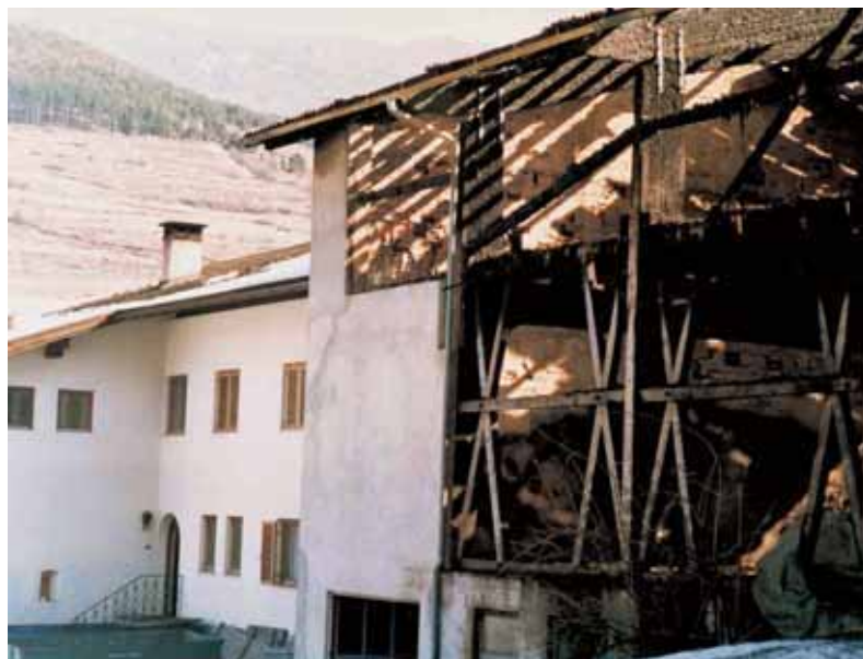
Fig. 15 - Il muro tagliafuoco ha impedito la propagazione dell'incendio
