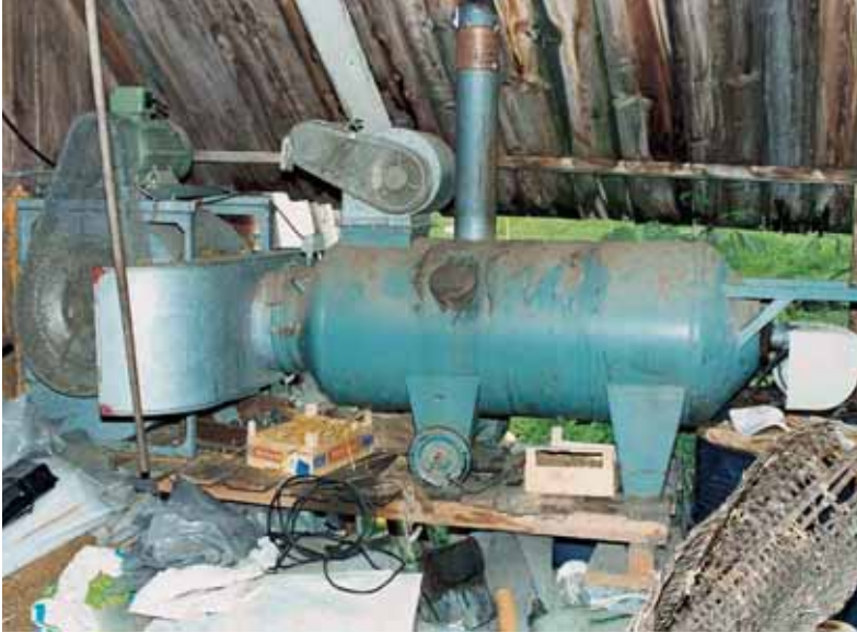
Fig. 4 - I generatori di aria calda devono essere in posizione tale da non provocare incendio
