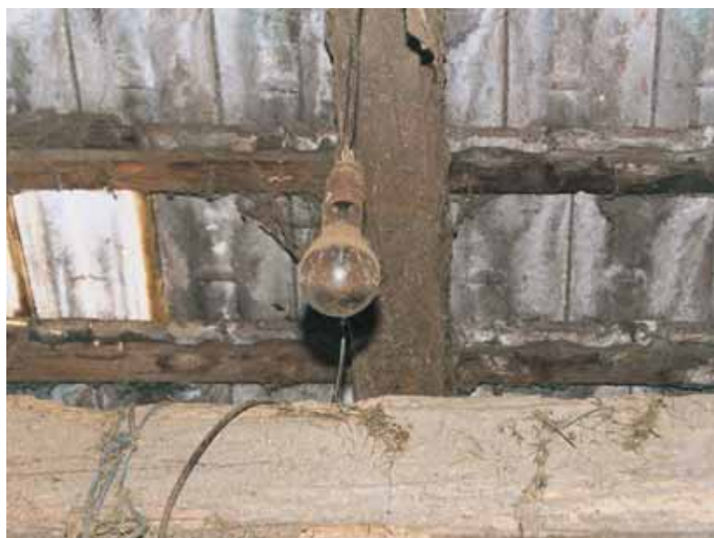
Fig. 10 - Lampade non protette che presentano superfici molto calde non possono essere utilizzate in locali polverosi
